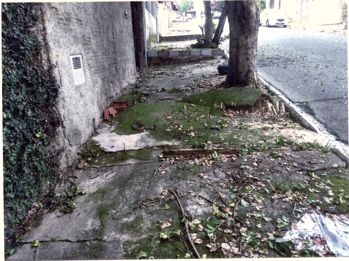
Raízes afloraram e destruíram a calçada, deixando sem acessibilidade
