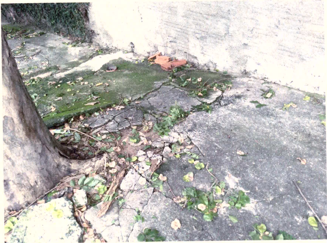
Raízes afloraram destruindo a calçada
