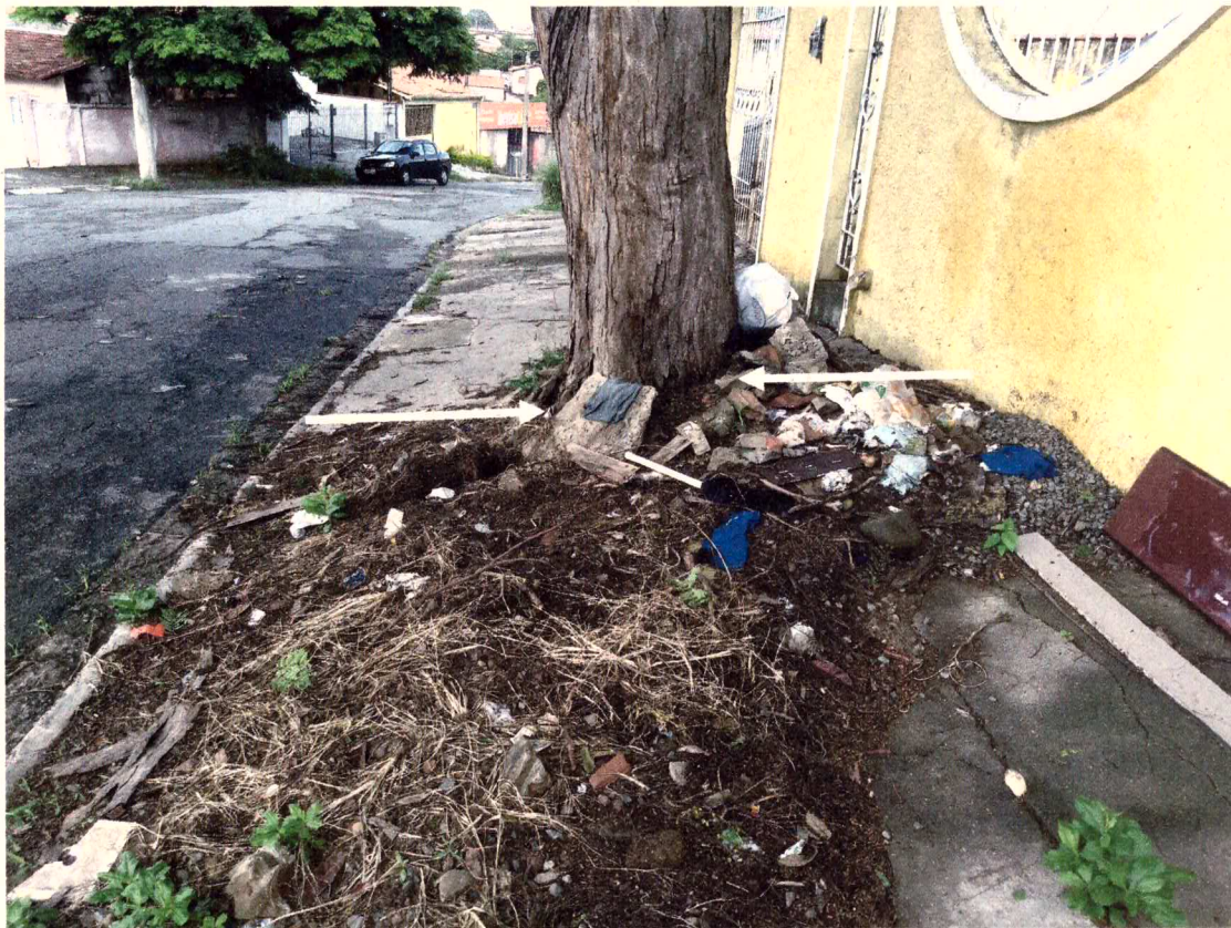
Plantada fora dos padrões do GAUC, fora do alinhamento.
