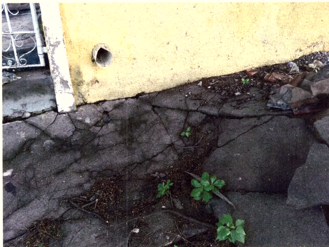
Raízes estão muito perto do muro e irão causar trincas.
